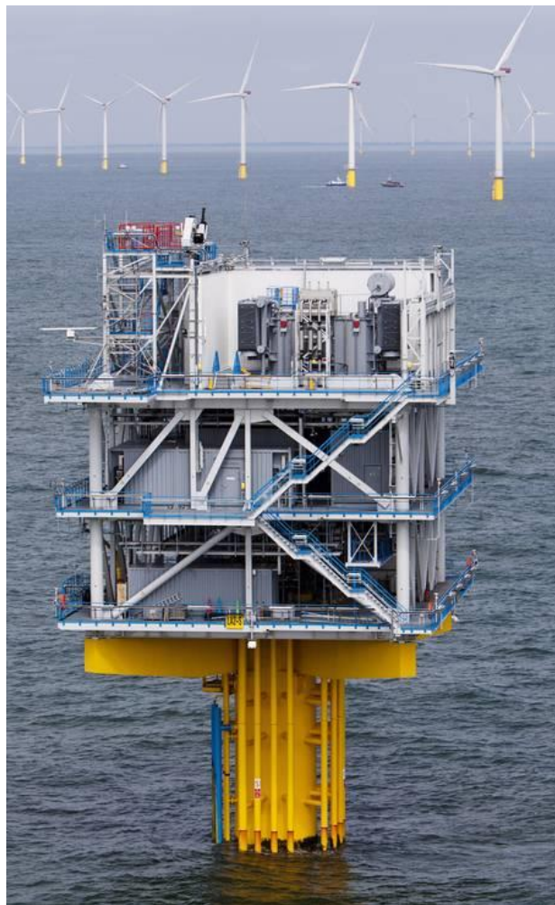
Subestação de parque eólico no mar em Cleve Hill, no Reino Unido. Cabos submarinos de mais de 50 metros de extensão conectam torres de aerogeradores aos equipamentos da alemã Siemens Foto: Divulgação/Siemens/05-07-2013
