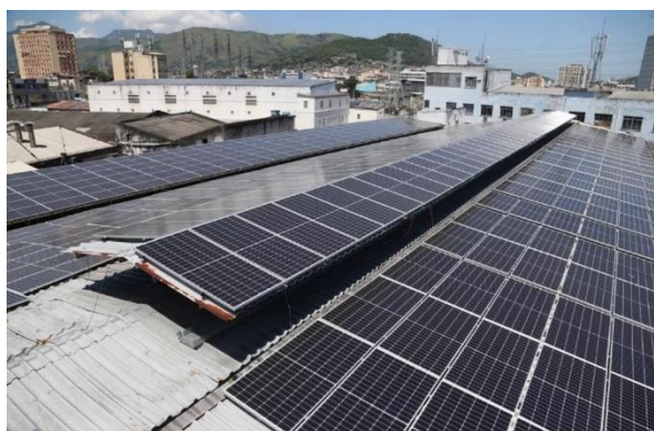
Placas de energia solar em telhado do Rio — Foto: Pedro Teixeira/ O Globo
